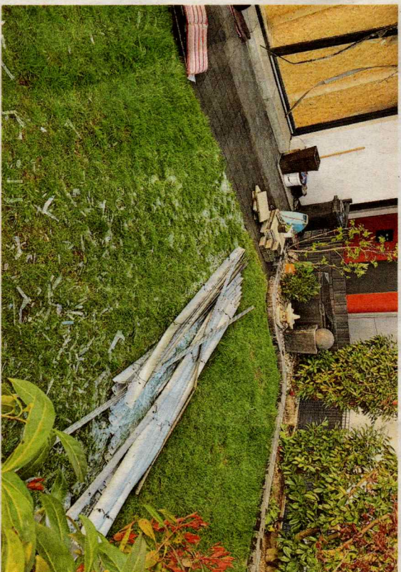
Überreste der Terrassentür liegen im Garten. Die Druckwelle, die nach der Explosion des Akkus entstanden ist, hat die Schiebelemente zerstört.
