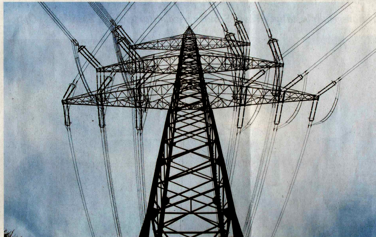
Neue Seile am alten Mast: Für den Ausbau der Stromtrasse zwischen Kupferzell und Gaukönigshofen müssen nur neue Leiterseile installiert werden. Die Errichtung weiterer Stahlträger ist nicht erforderlich.
